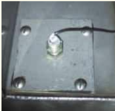
Kontrolllucka / tank med varningssystem för vattennivå.
